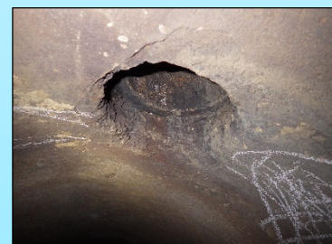
写真-12 分水弁(管頂)
